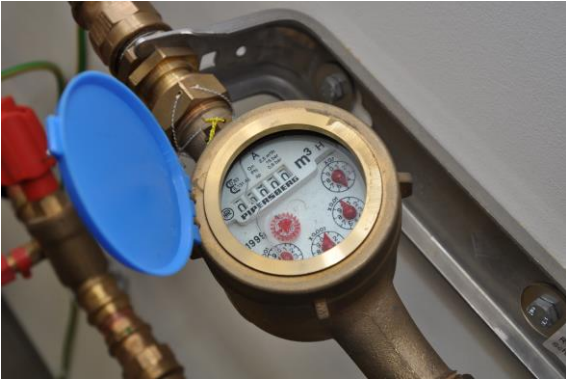
Der Übergabepunkt - die Wasseruhr trennt die Verantwortungsbereiche.
